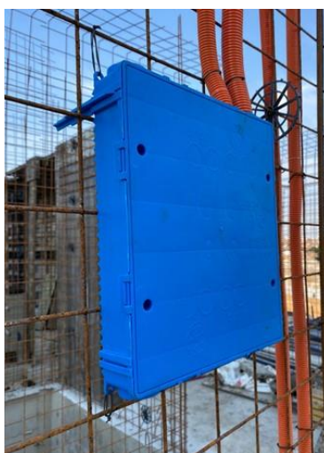
Quadro para até 24 disjuntores
