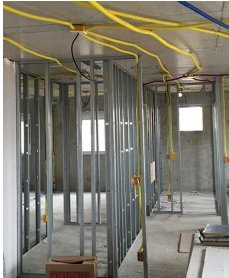
Eletródutos em forros e paredes drywall
